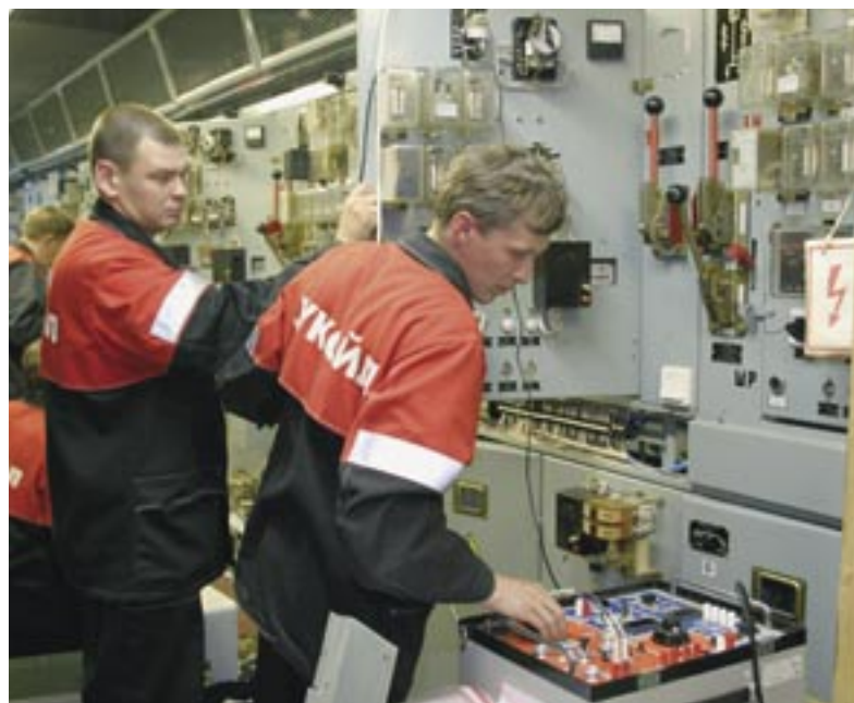
Im Leitstand einer Erdölförderanlage von Lukoil
